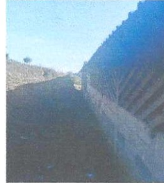
Foto 2: Paredes de la escuela en malas condiciones.
