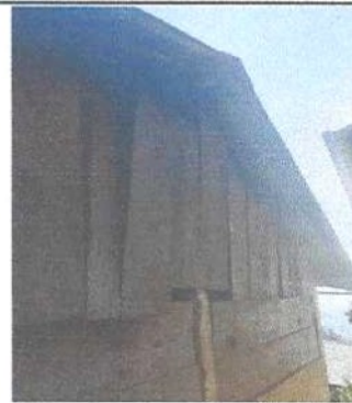
foto 4 : se observa el estado de las paredes de la escuela y su techo.
