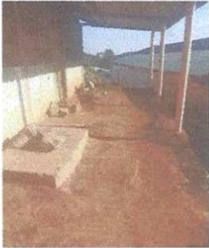
Foto 1: Estado actual de piso de la escuela.
