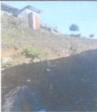
Foto 3: El baño se encuentra deteriorado en paredes, puertas y techo.
