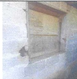
foto 6: se observa el estado de las ventanas del establecimiento.
